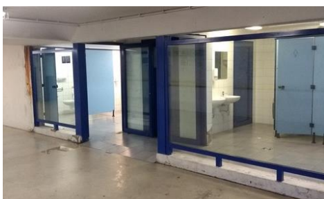
Voorbeeld: sanitair parking ZUID, vanuit de gang een goed zicht op de sanitaire installaties, de wanden en deuren van de wc's staan los van de grond en het plafond. Maximale sociale controle, minimum aan privacy.
