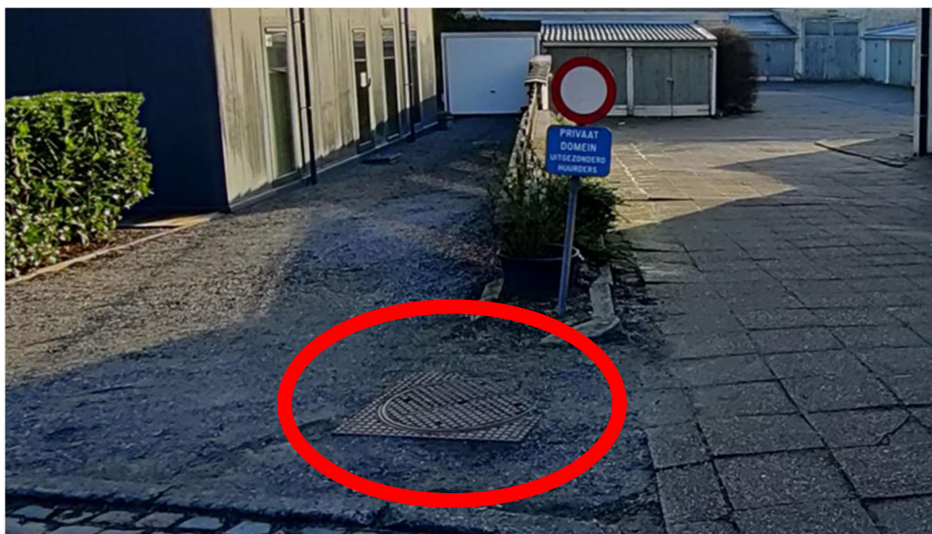
Figuur 8: Foto 2021: deksel van de riolering
