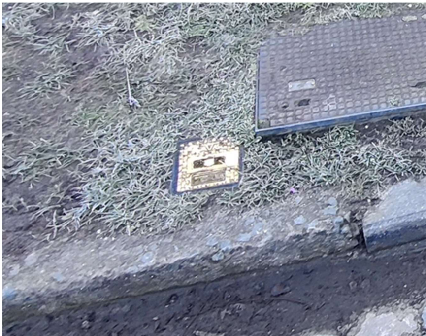
Figuur 6: Foto 2021: afsluiter van de gasleiding
